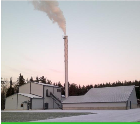
Uusikaarlepyy, Laka 3 + 3 MW
