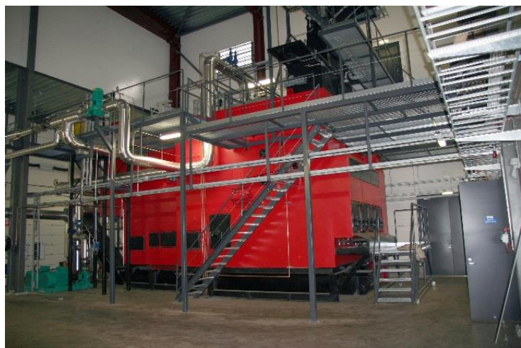
Pansion lämpökeskus 12 MW Kattilat: Laka Y 5 MW ja 7 MW Lämmöntuotanto vuodessa n. 90 GWh
