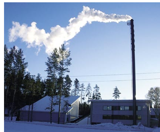
Laatukattila toimitti Hauhon kuntaan 2 MW:n biokattilalaitoksen vuonna 2004.
