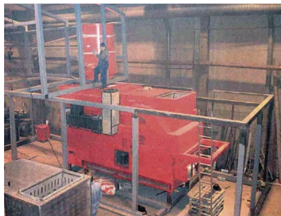
Järeä biolämpökeskus syntyy verstaalla hallitusti kokonaisuus kerrallaan. Tämä 1,5 MW:n tehoinen kattilalaitos päätyi Pornaisiin.
